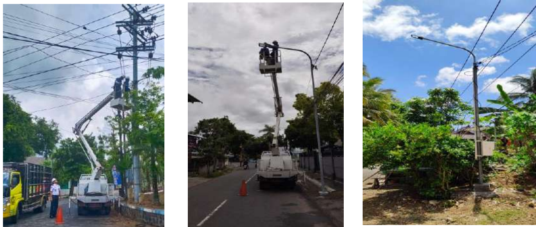
Gambar 3.2 Pemasangan dan Pemeliharaan PJU Kabupaten Pacitan
