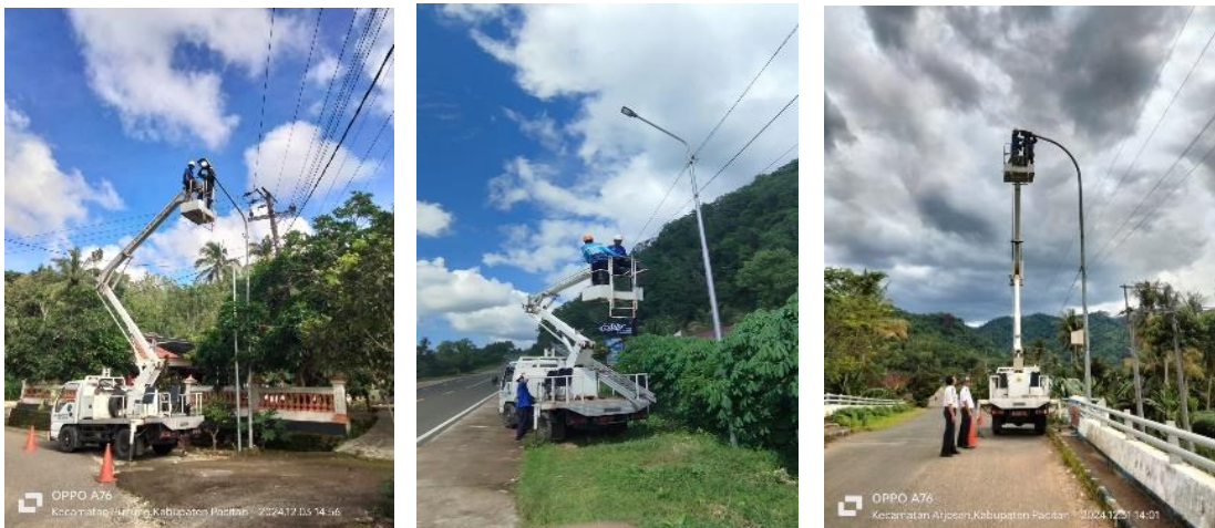
Gambar 3.4 Pemasangan dan Pemeliharaan PJU Kabupaten Pacitan
